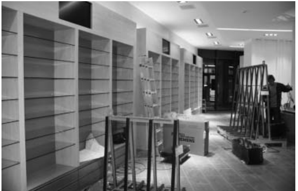
Ein erster Blick in die neue Drogerie-Apotheke Lacuna. Noch wird fleissig gebaut.
